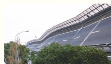
倒壊した高速道路
